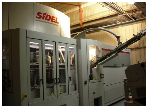
Machine où les préformes de bouteilles sont chauffées puis soufflées
